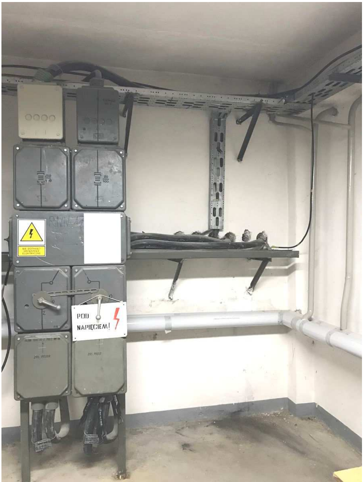
Zdj.3 – pom. rozdzielni RNN13
