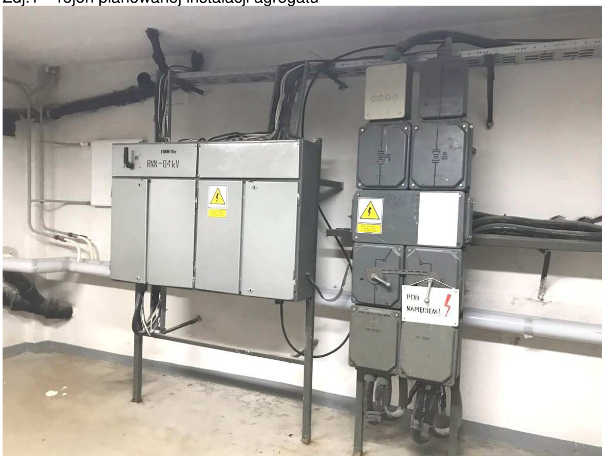
Zdj.2 – pom. rozdzielni RNN13
