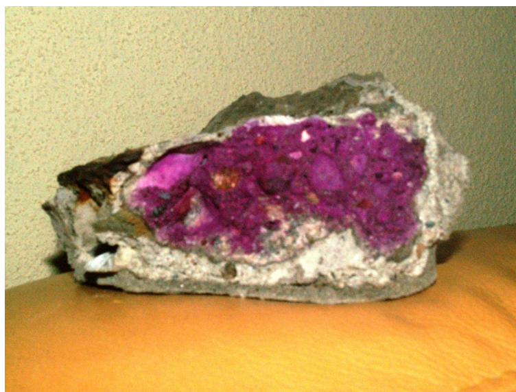
Rys. 10. Badanie zasięgu karbonatyzacji na przełomie odspojonej otuliny zbrojenia
