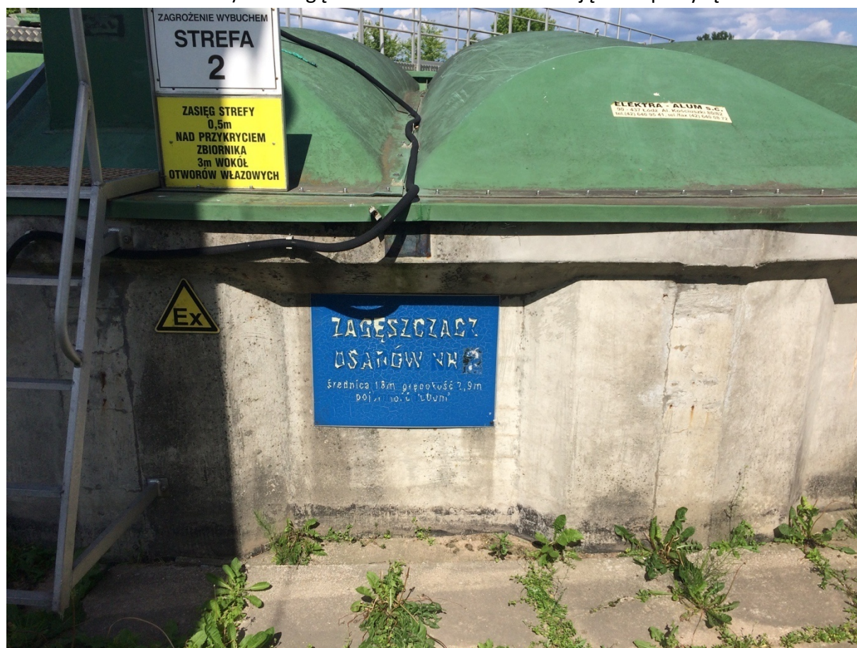
Rys. 15. Widok na zagęszczacz osadów
