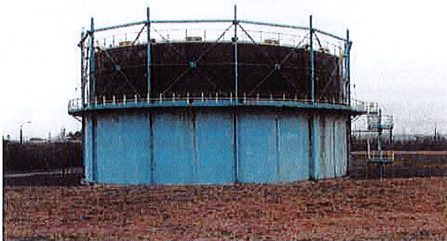
Istniejący zbiornik biogazu
