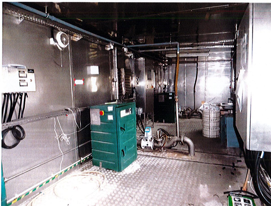
2. Wnętrze kontenerowej stacji zlewnej nieczystości ciekłych
